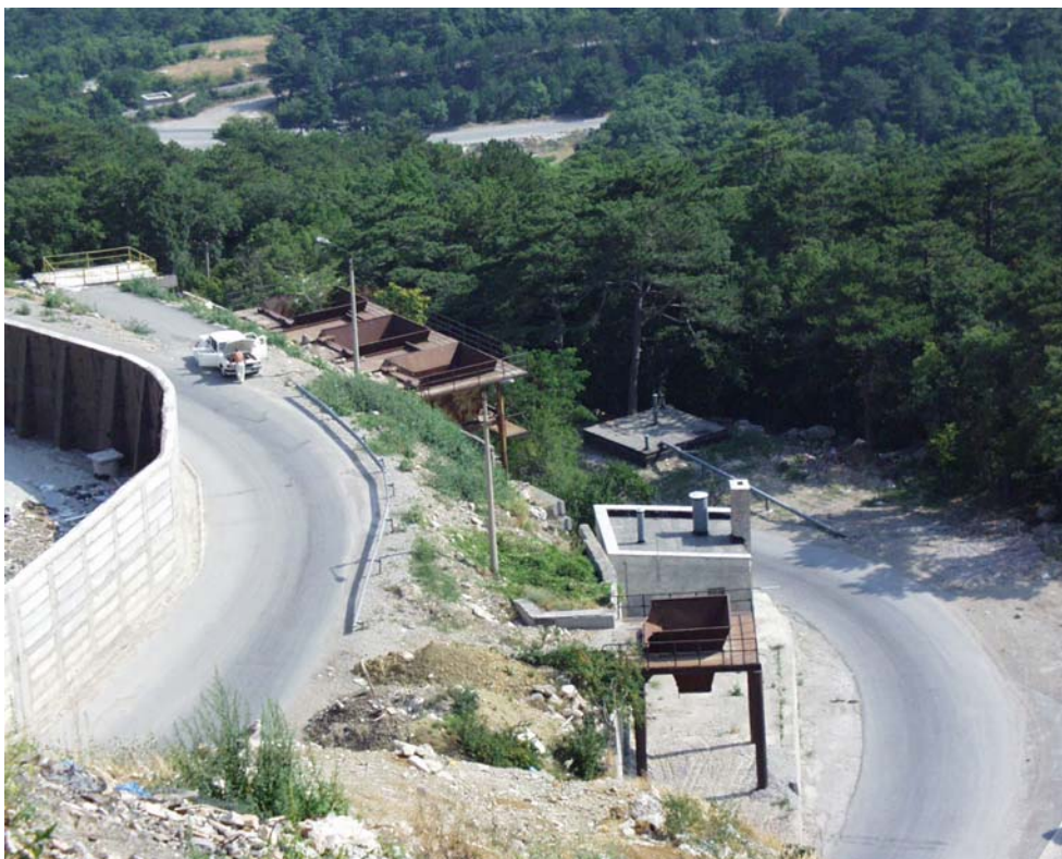
Рис. 52. Ялтинский полигон: Бункеры для перегрузки отходов
