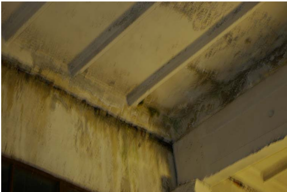
Photo 32 Fuites dans la toiture
