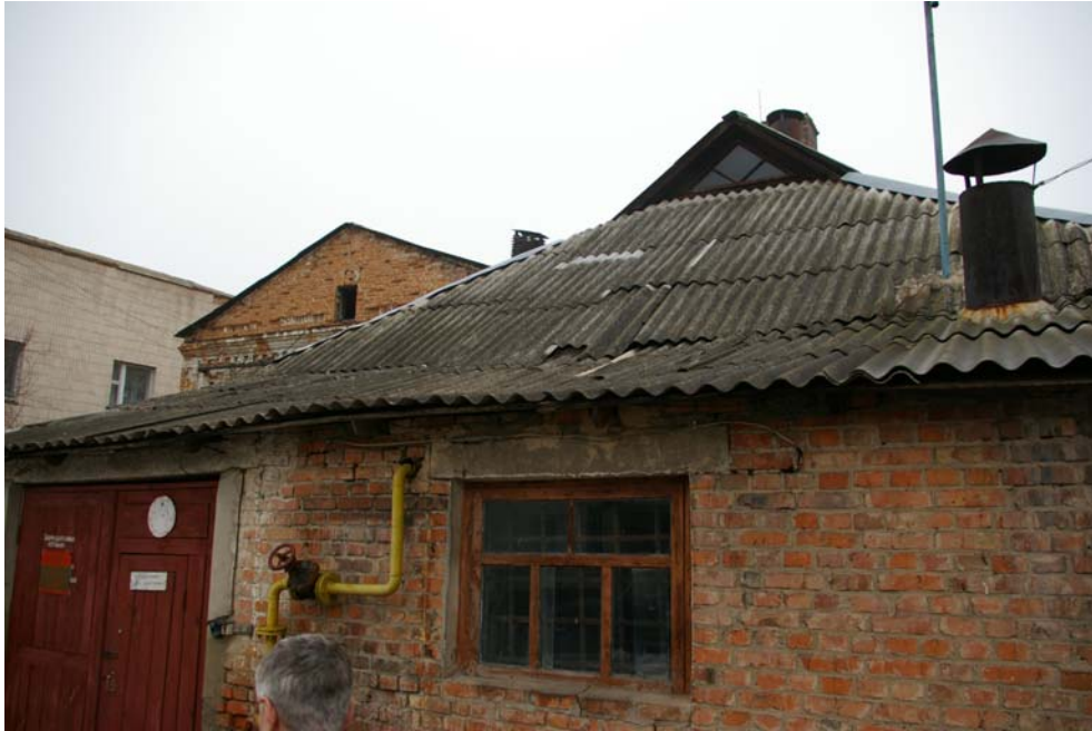
Photo 73 Effondrement du toit
