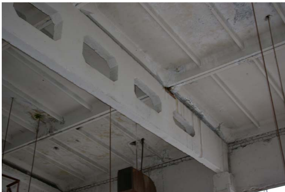
Photo 44 Traces de fuites de toiture
