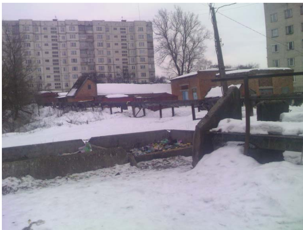
Photo 54 État du départ de réseau de chaleur
