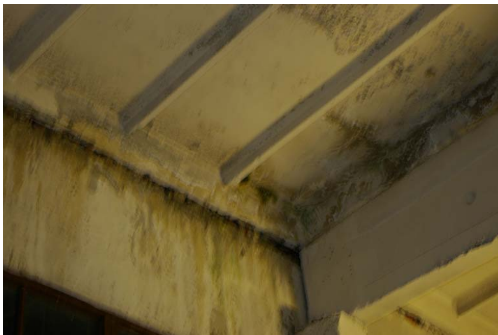
Photo 104 Fuites dans la toiture
