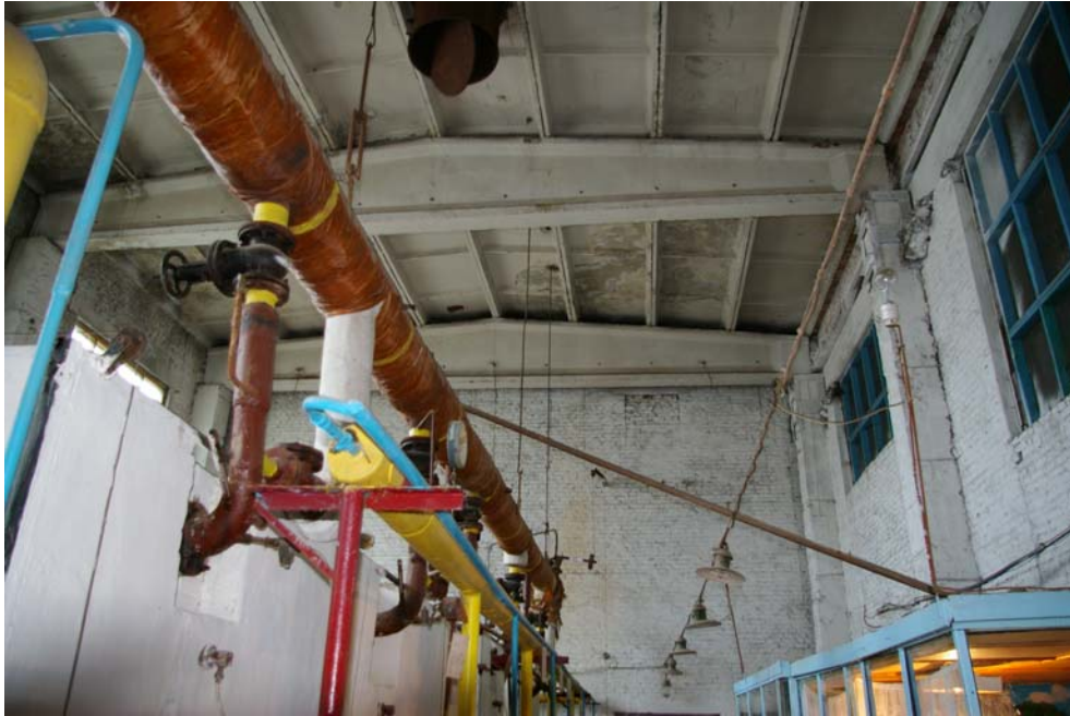
Photo 4 Traces de fuites de toiture
