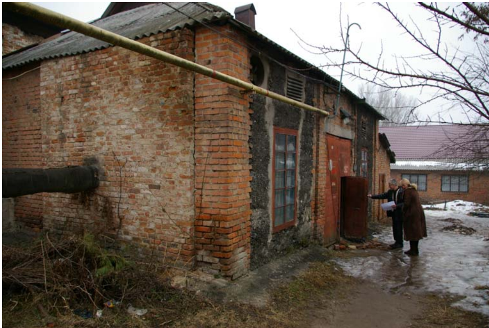
Photo 72 Chaufferie de Moskovska 29
