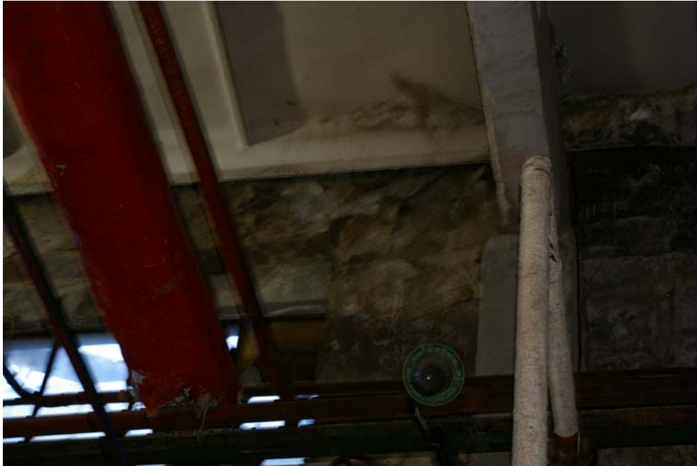
Photo 87 Traces de fuites de toiture
