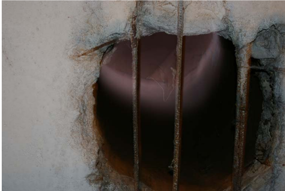
Photo 65 Bouche de ventilation
