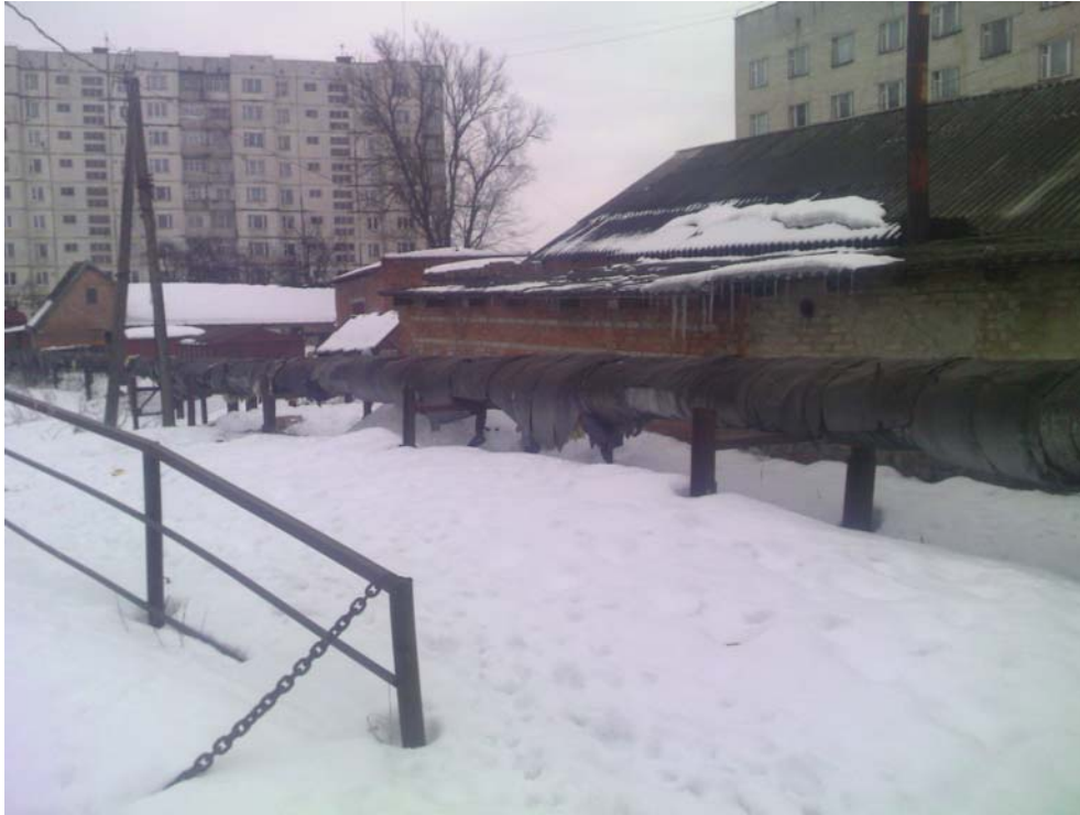
Photo 55 Arrière de la chaufferie
