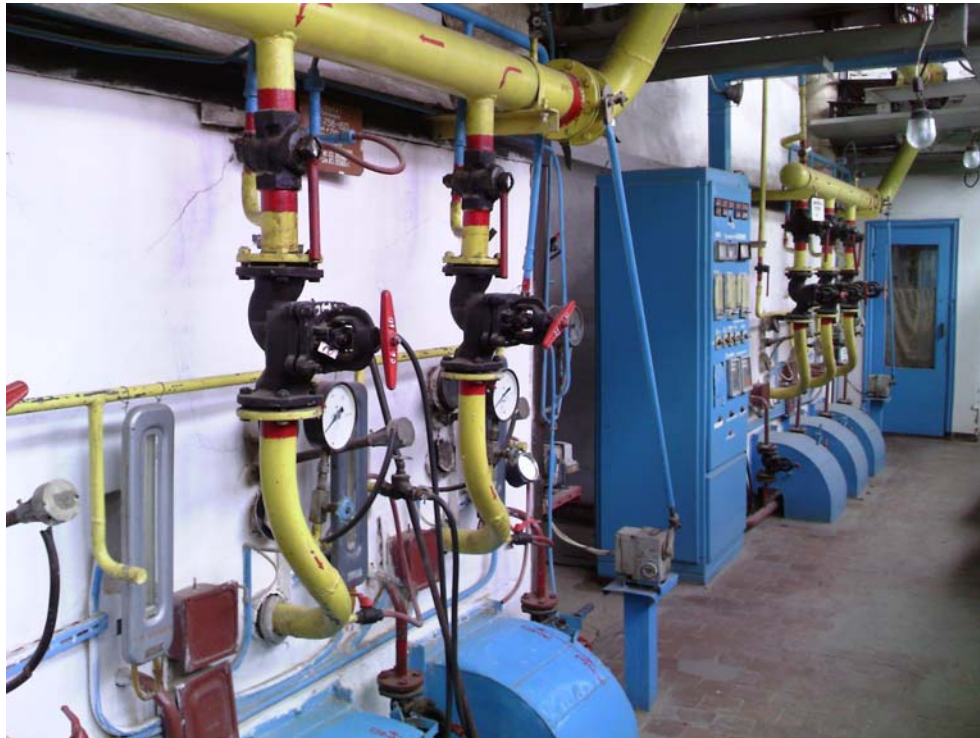
Photo 23 Chaudières devant disparaître de la salle annexe
