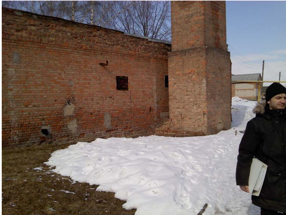
Photo 14 Arrière de la chaufferie
