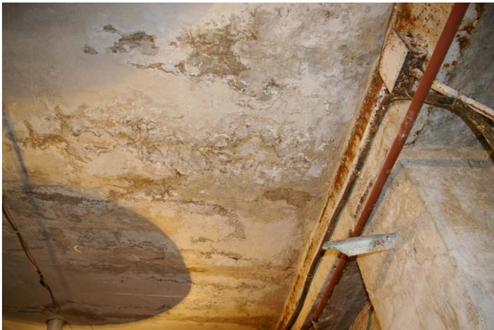
Photo 17 Traces de fuites à l'intérieur
