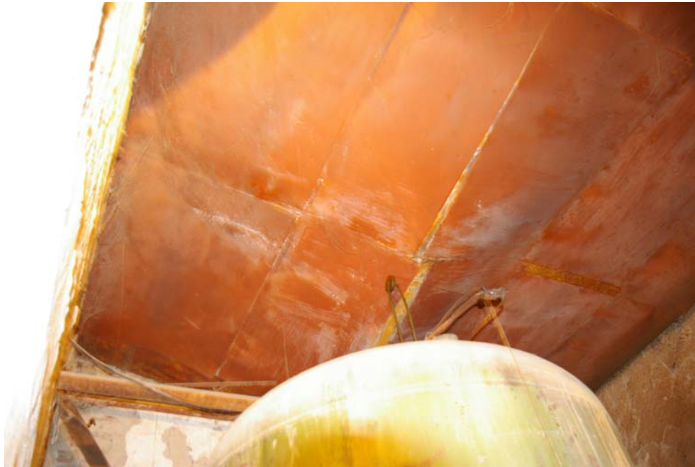
Photo 75 Effondrement du plafond
