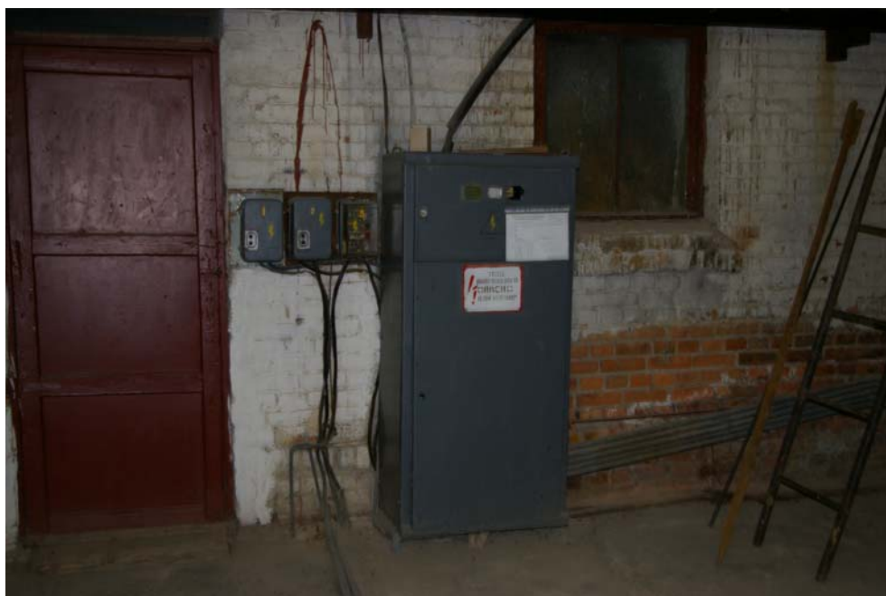
Фото 105 Електрична розподільча шафа
