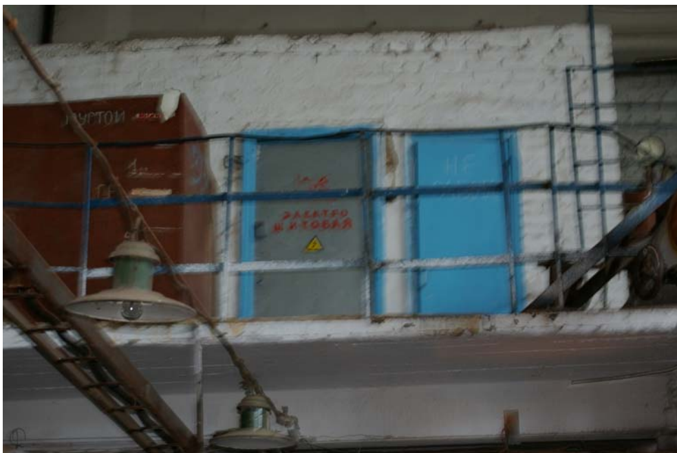
Фото 5 Електрична розподільча шафа
