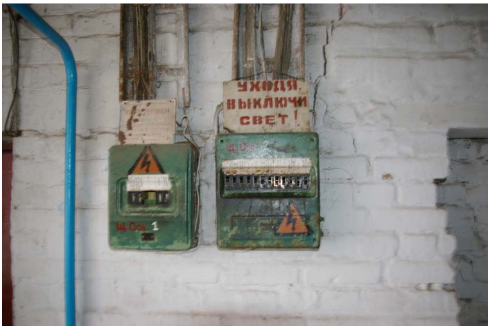
Фото 45 Електрична розподільча шафа
