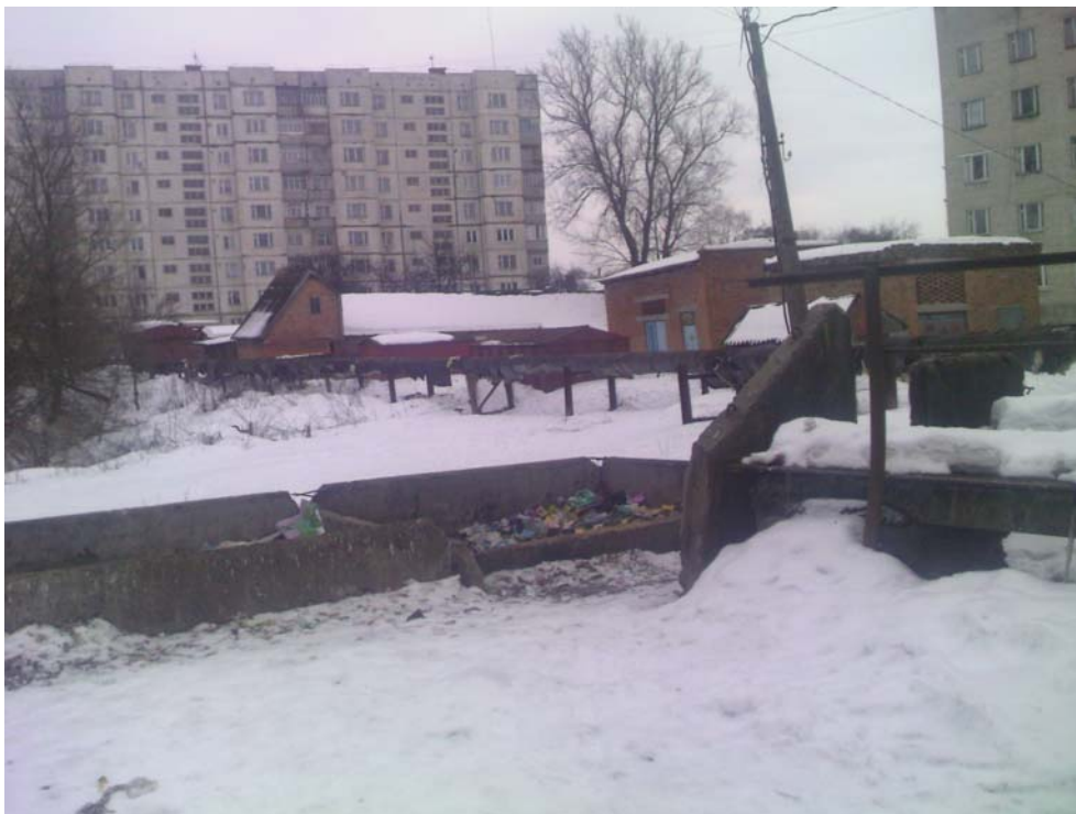
Фото 54 Стан теплотраси на вході в мережу теплопостачання
