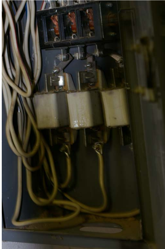
Фото 99 Електрична розподільча шафа
