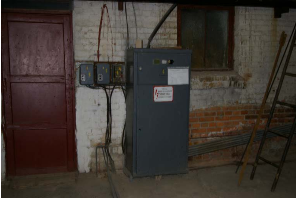
Фото 33 Електрична розподільча шафа
