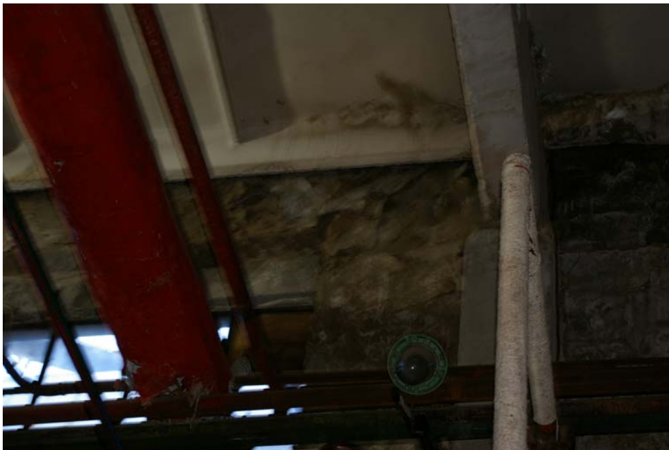
Фото 87 Сліди протікання даху
