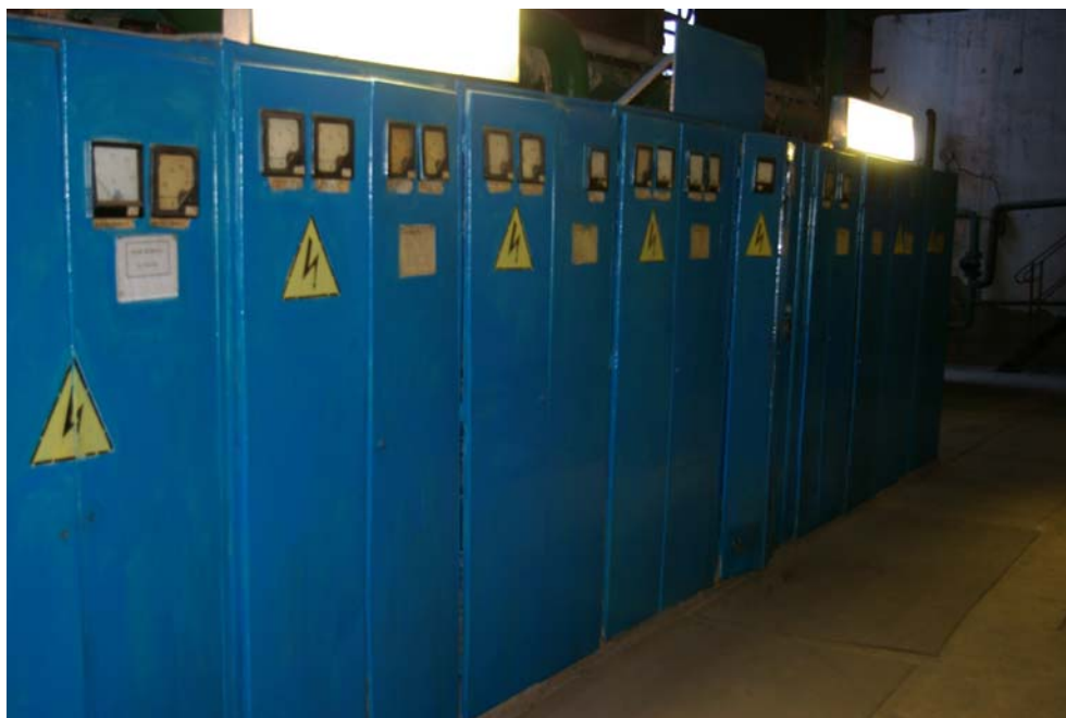
Фото 91 Електрична розподільча шафа
