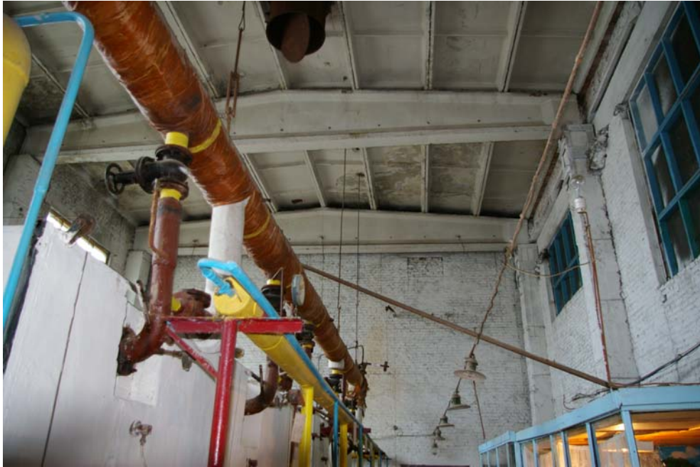
Фото 4 Сліди протікання даху
