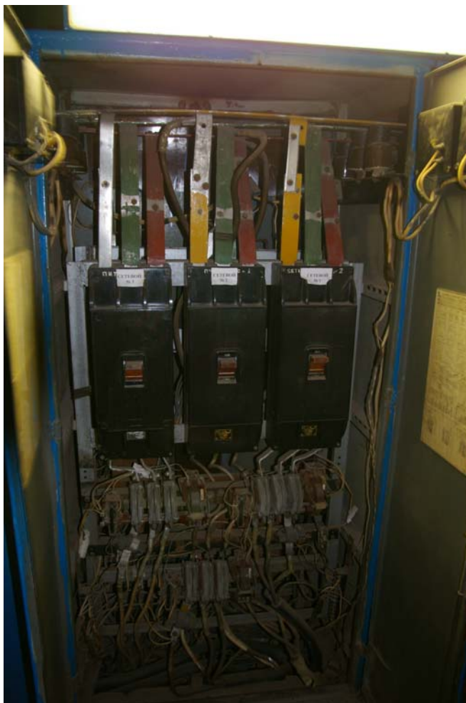
Фото 88 Електрична розподільча шафа
