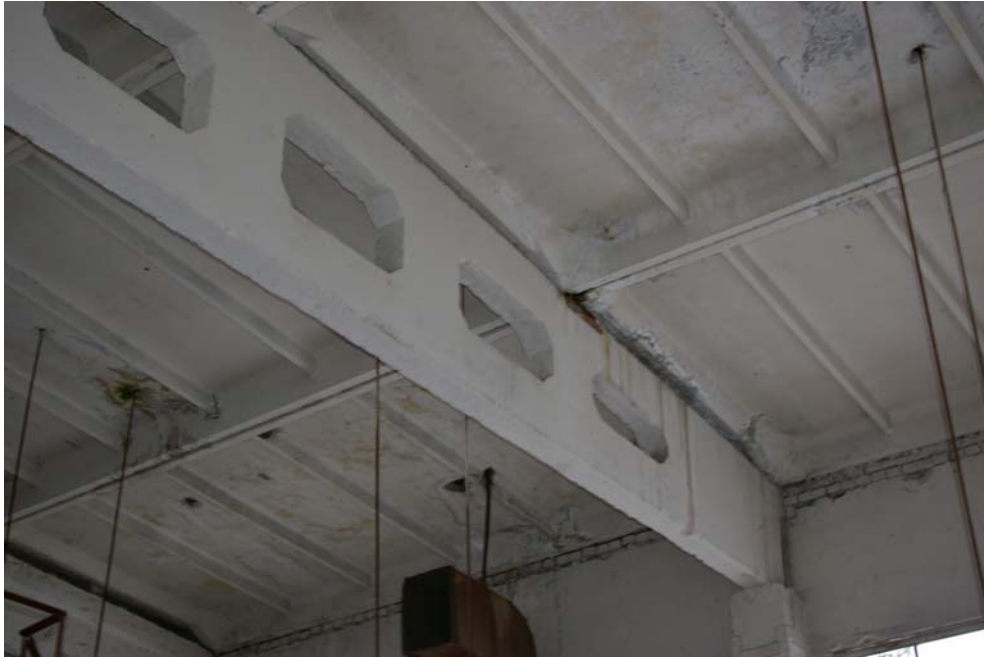
Фото 44 Сліди протікання даху
