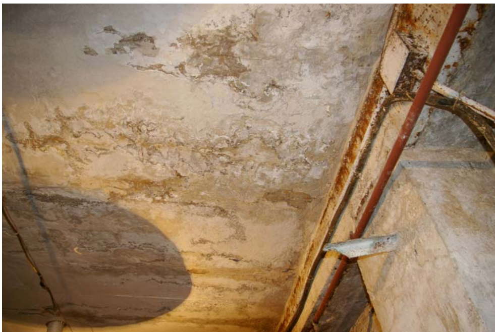
Фото 17 Сліди протікання всередині
