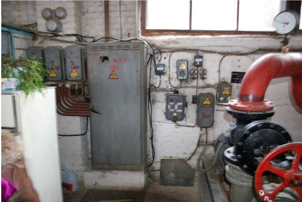
Фото 71 Електрична розподільча шафа
