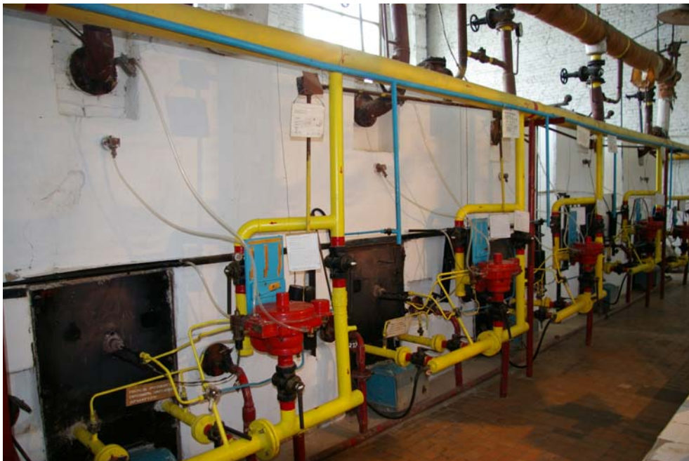
Фото 1 Котли, що підлягають заміні
