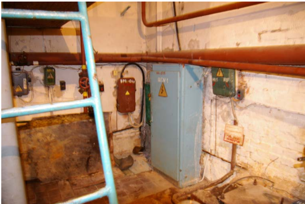
Фото 19 Електрична розподільча шафа
