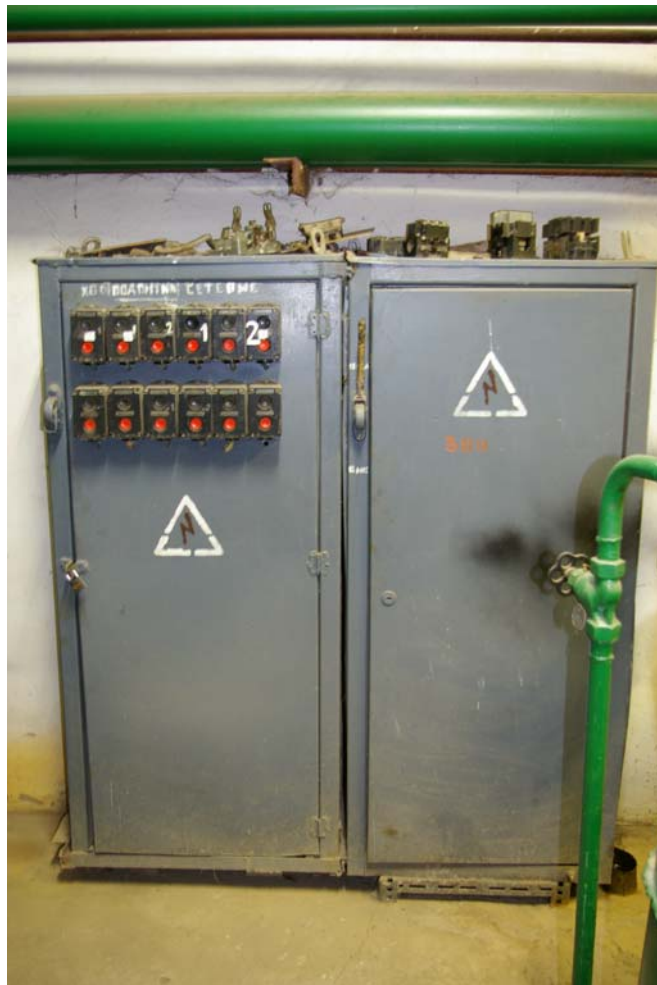
Фото 98 Електрична розподільча шафа
