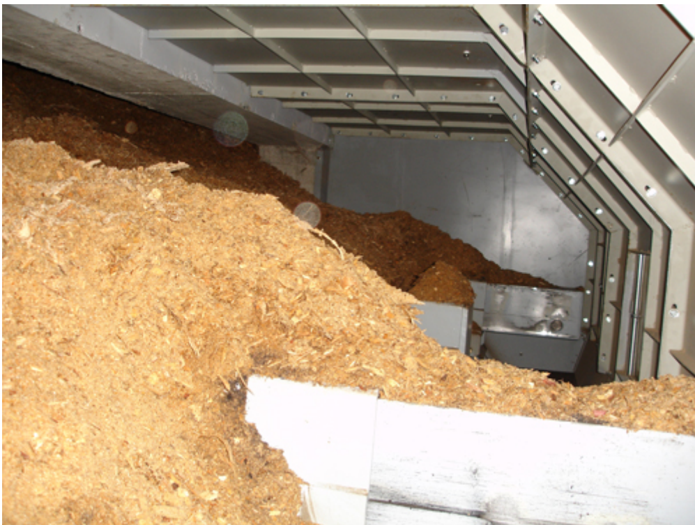
Фото 112 Внутрішній вигляд накопичувального бункера
